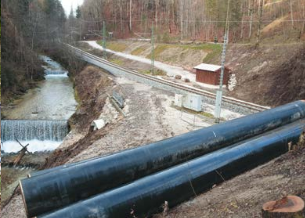
Nach Errichtung der Schwarzbauten; Straßen, Hütte, Waldrodung, Hangabtragung, Durchlass
